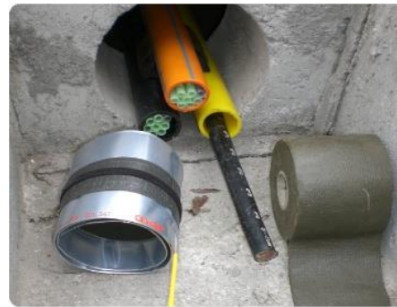
2) Infraestructura de la RDNFO (Ductería y Canalizaciones)
